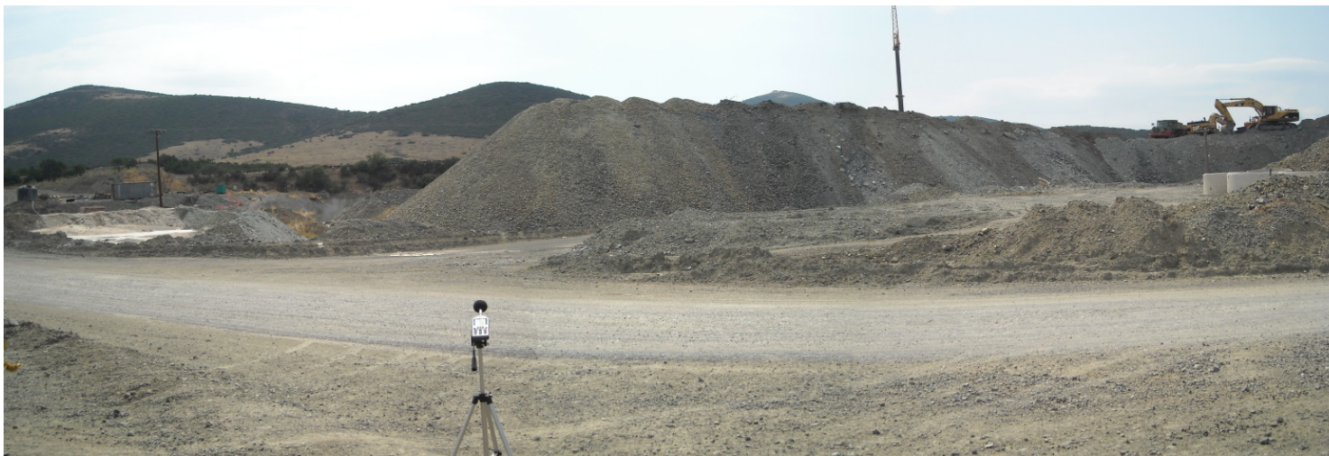
Φωτ. 10.2.1-1 Ενδεικτική εικόνα από το τοπίο κατά τη φάση κατασκευής σιδηροδρομικού έργου μεγαλύτερης κλίμακας.
