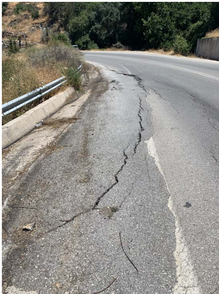
Εικόνα 3.2.: Ρωγμές επί της οδού (31-N23Π).
