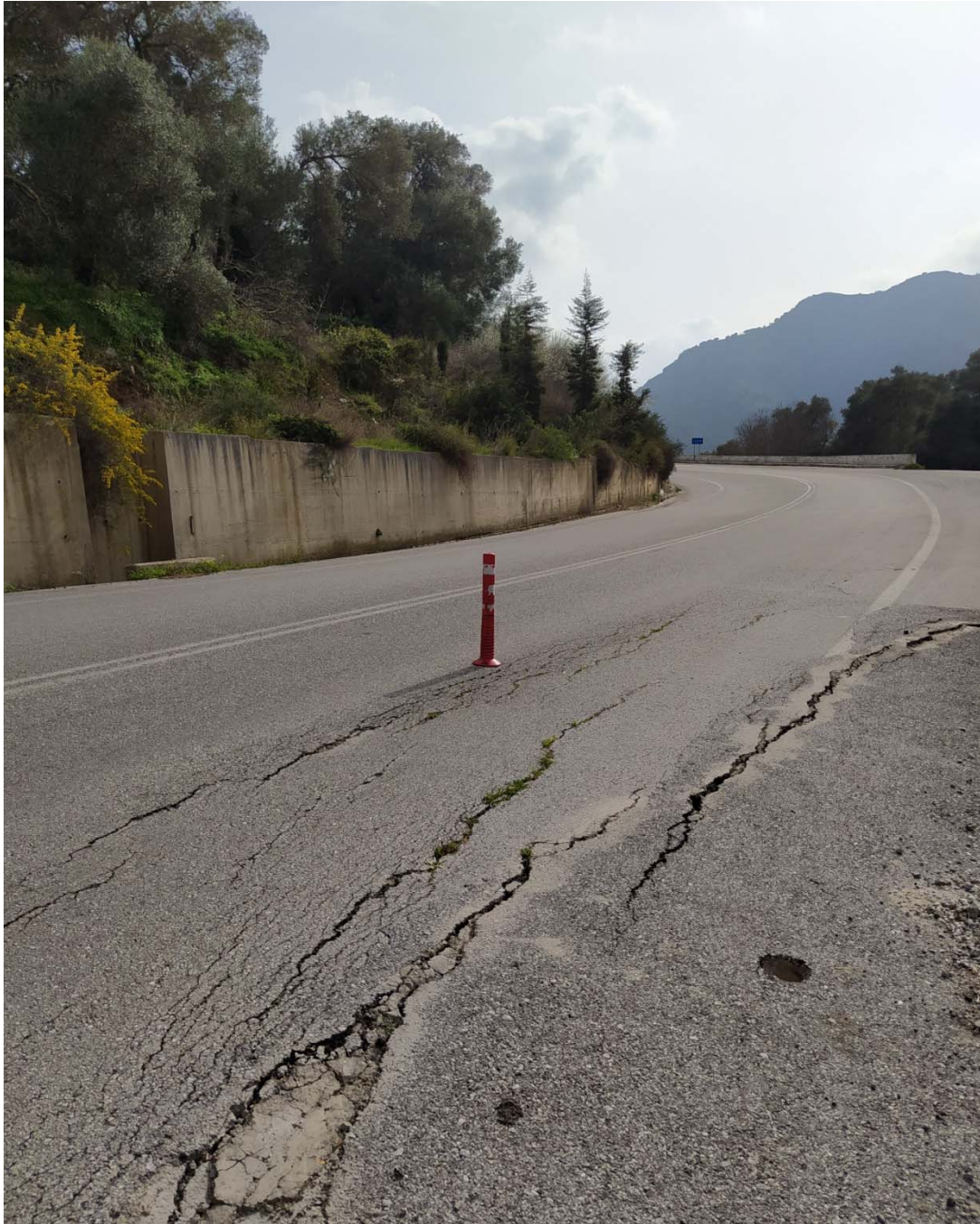
Φωτογραφία 1: Όψη τοιχίου αντιστήριξης στο ανάντη τμήμα της Ε.Ο. με ενδείξεις νερού στα σημεία αποστράγγισης - Ρωγμές στο οδόστρωμα στο κατόντη τμήμα της Ε.Ο. στην περιοχή εκδήλωσης των κατολισθητικών φαινομένων
