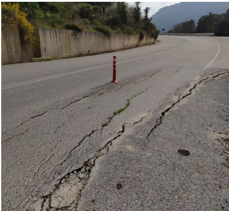
Εικόνα 3.3.: Ρωγμές επί της οδού (31-N23Π) κ η όψη του τοιχίου στο ανάντη πρανές.
