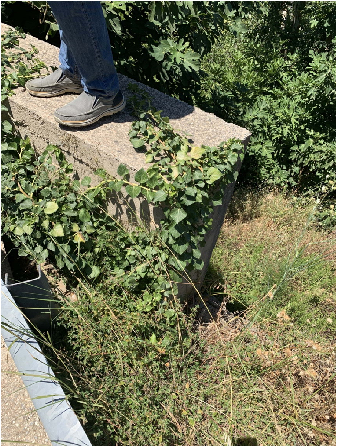
Φωτογραφία 3: Μετακίνηση τοιχίου στο κατάντη τμήμα της Ε.Ο. στην περιοχή εκδήλωσης των κατολισθητικών φαινομένων
