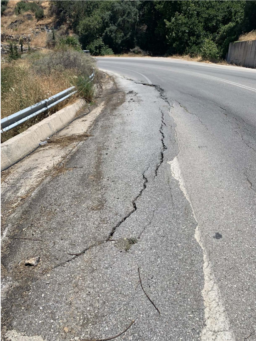
Φωτογραφία 2: Ρωγμές στο οδόστρωμα (πεταλοειδούς μορφής) στο κατάντη τμήμα της Ε.Ο. στην περιοχή εκδήλωσης των κατολισθητικών φαινομένων
