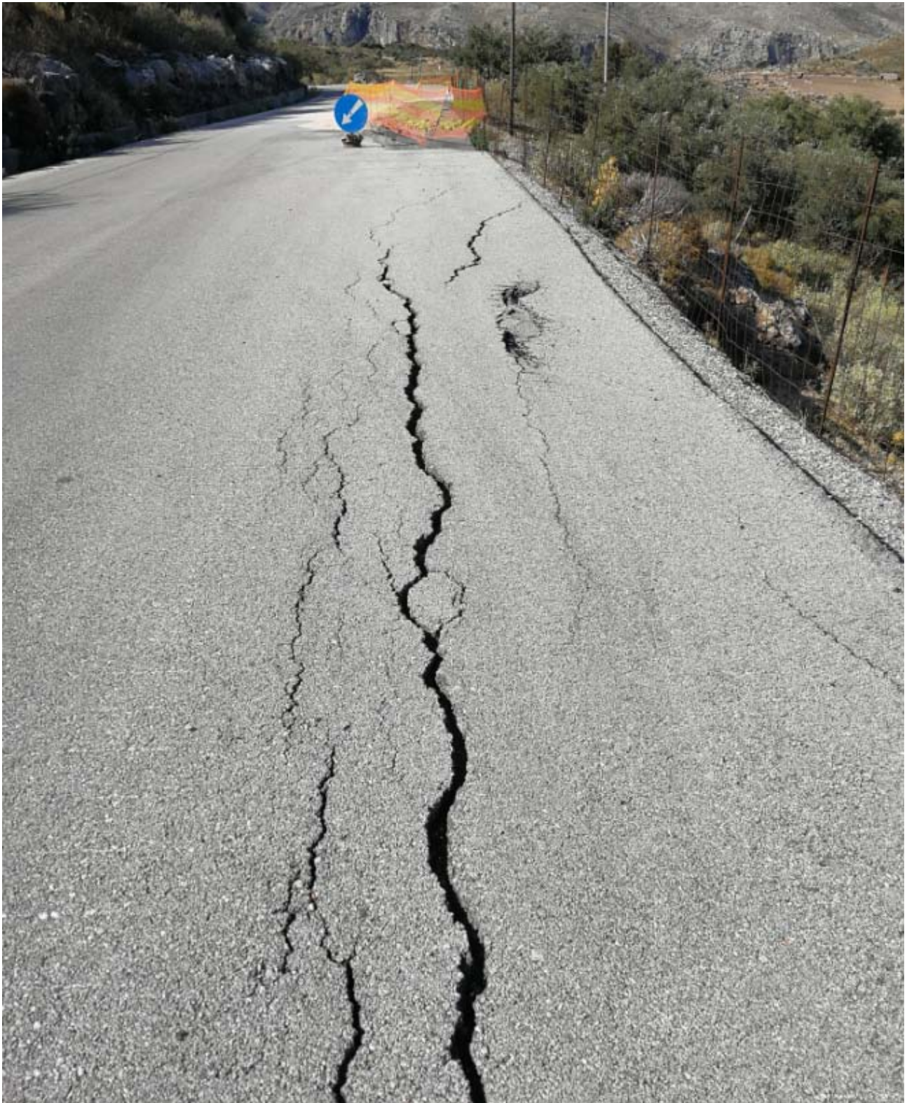
Εικόνα 2.2 - Λήψη 10/19 - Κατεύθυνση προς Καλουδιανά. Ρωγμές κατά μήκος του οδοστρώματος.
