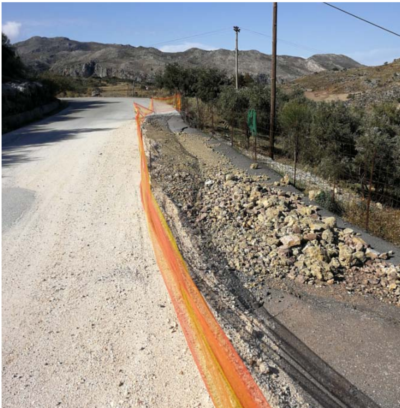
Εικόνα 2.1 - Λήψη 10/19 - Κατεύθυνση προς Καλουδιανά. Κατάρρευση οδοστρώματος
