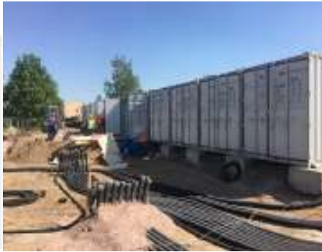
Εικόνα 2 Ενδεικτική τοποθέτηση κέντρου ελέγχου και container εντός της περιοχής εγκατάστασης συστήματος αποθήκευσης /συσσωρευτών. Τυπική διάταξη μονάδων μπαταριών.
