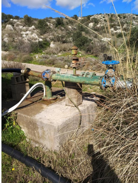
Φωτογραφία 16 – Αντλιοστάσιο Δ4
