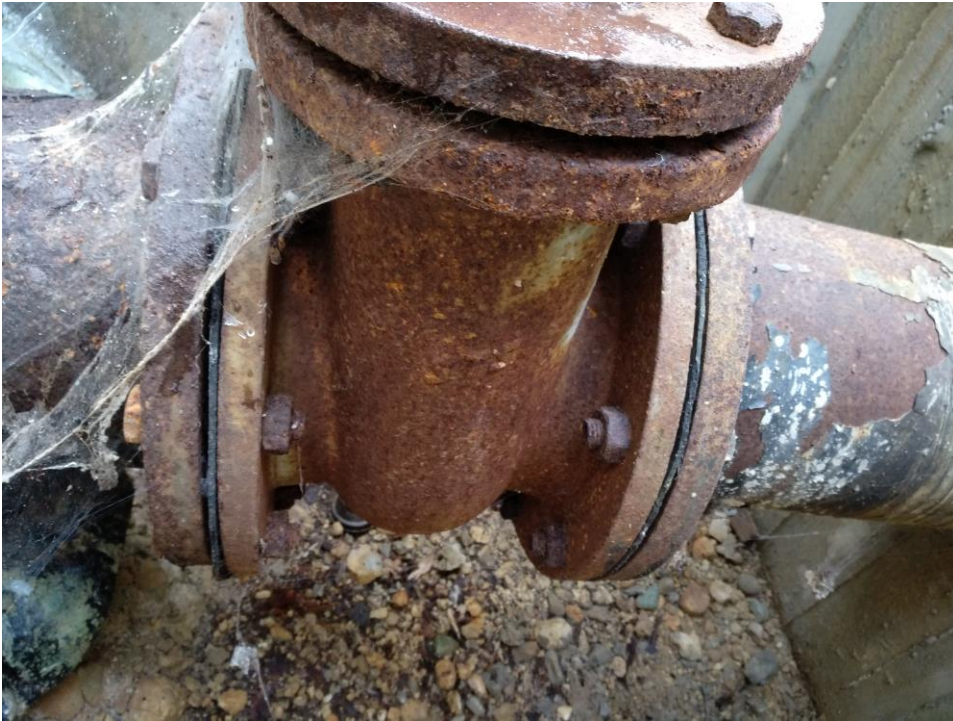
Φωτογραφία 6 – Υδραυλικά Δεξαμενής Α
