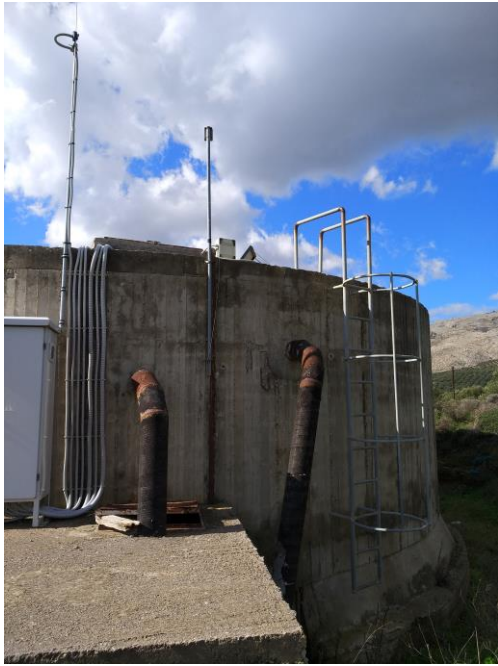
Φωτογραφία 9 – Υδραυλικά Δεξαμενής Δ
