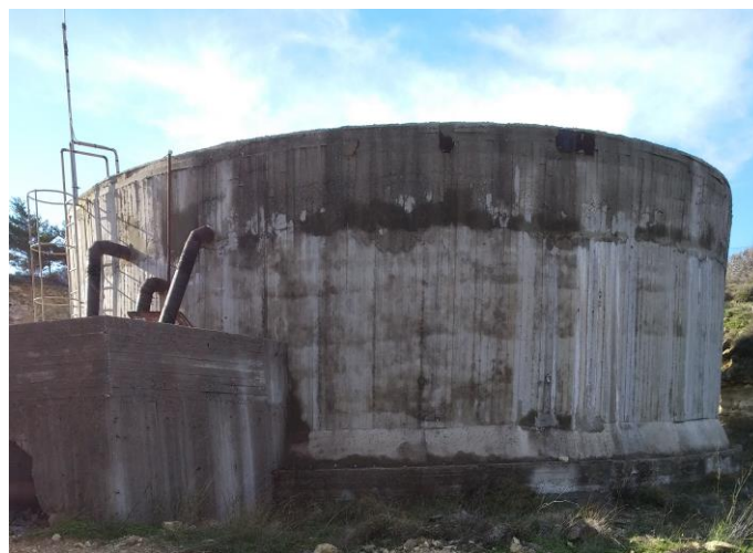
Φωτογραφία 2 – Δεξαμενή Β
