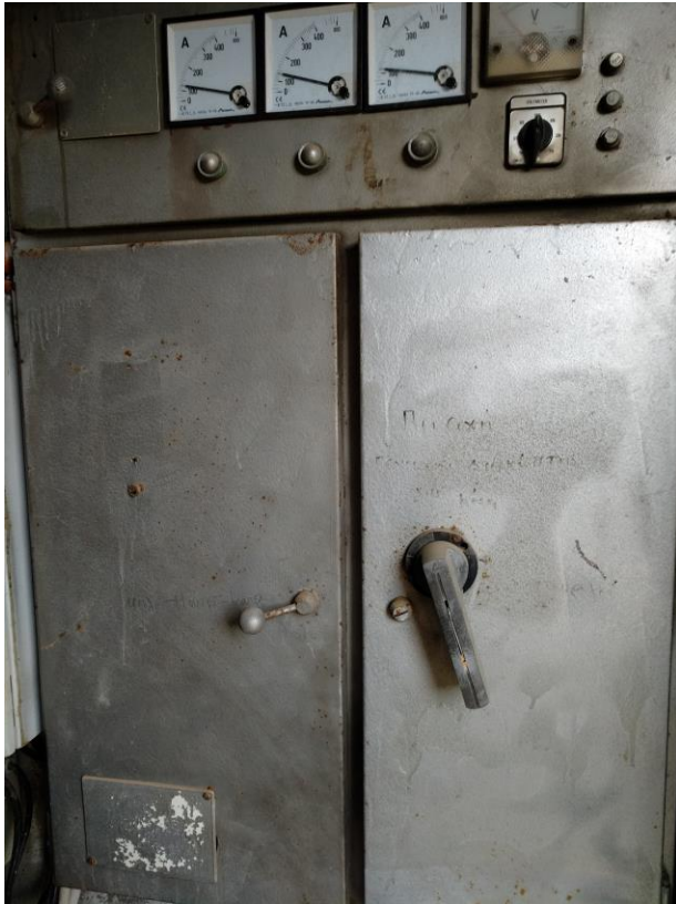
Φωτογραφία 19 – Ηλεκτρολογικοί Πίνακες 1
