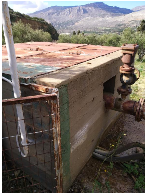
Φωτογραφία 18 – Αντλιοστάσιο K3
