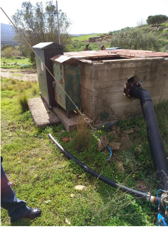
Φωτογραφία 17 – Αντλιοστάσιο K2
