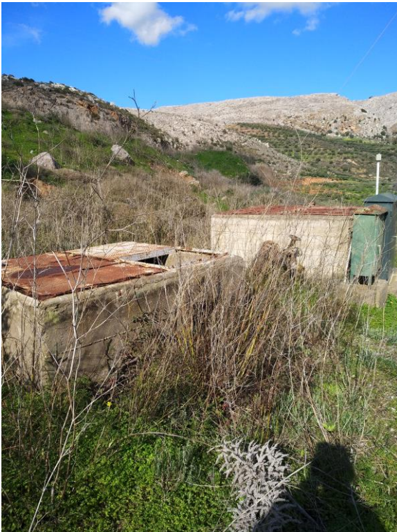
Φωτογραφία 15 – Αντλιοστάσιο Δ1
