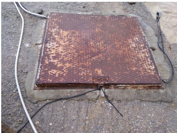
Φωτογραφία 11 – Κάλυμμα Δεξαμενής Β
