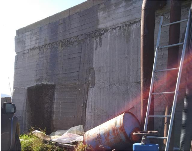
Φωτογραφία 3 – Δεξαμενή Γ
