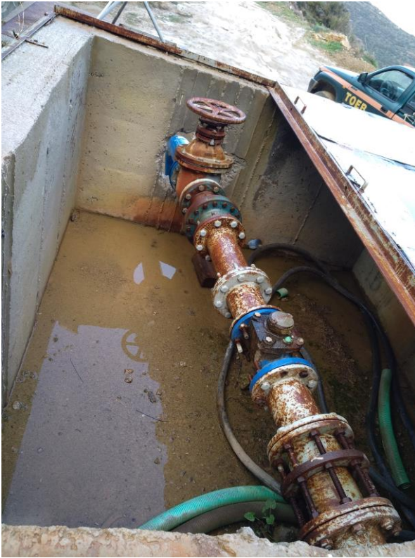
Φωτογραφία 13 – Αντλιοστάσιο Π3
