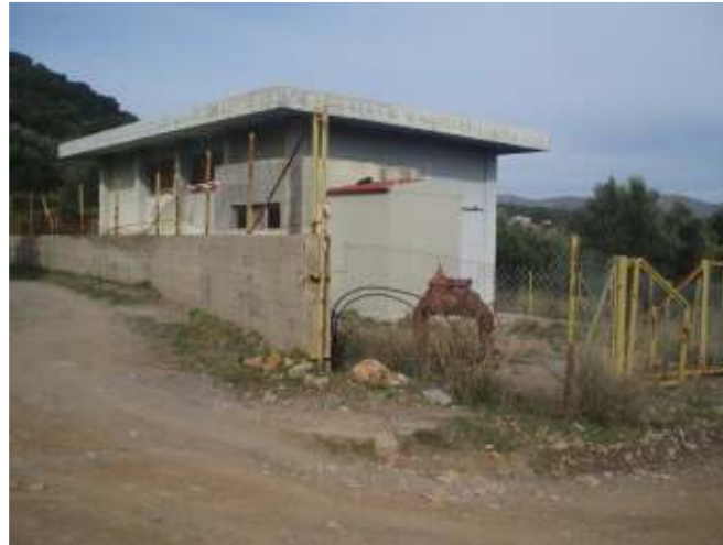
Γεώτρηση Λ1 και προωθητικό αντλιοστάσιο Λ
