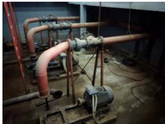
Εσωτερικό αντλιοστασίου Λ
