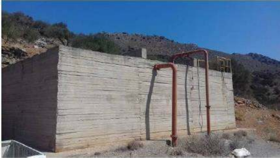
Δεξαμενή συγκέντρωσης Αγ. Λουκά που υδροδοτείται από την κεντρική δεξαμενή Λ μέσω του προωθητικού αντλιοστασίου Αγ. Λουκά και αρδεύεται βαρυντικά το ανατολικό τμήμα της περιοχής Μέσα-Έξω Λακωνίων
