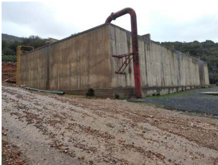
Κεντρική Δεξαμενή Λ που υδροδοτείται από τις γεωτρήσεις Λ1-Λ2-Λ3 μέσω του προωθητικού αντλιοστασίου Λ και αρδεύεται βαρυντικά η περιοχή Δ.Κ. Λιμνών
