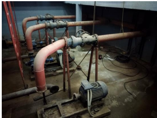
Εσωτερικό αντλιοστασίου Λ
