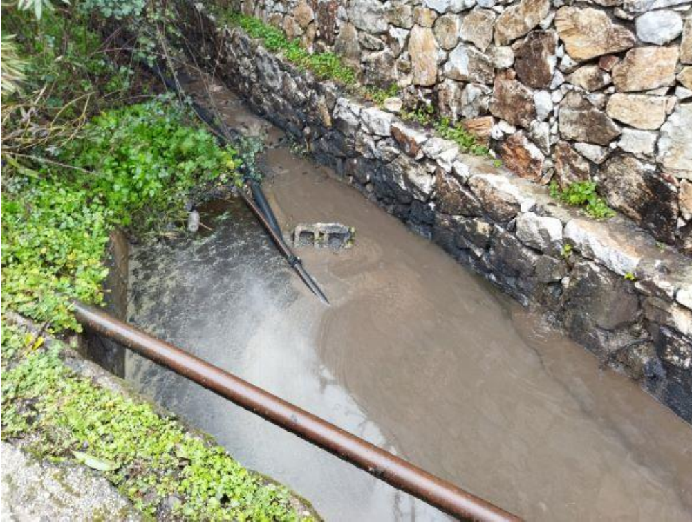
Φωτ. 3. Διαρροές στραγγισμάτων εκτός της εγκατάστασης (13-01-2022).
