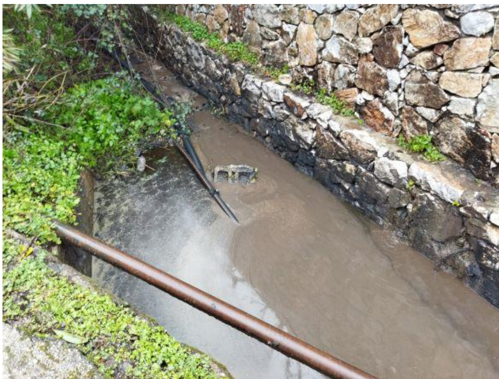
Φωτ. 3. Διαρροές στραγγισμάτων εκτός της εγκατάστασης (13-01-2022).
