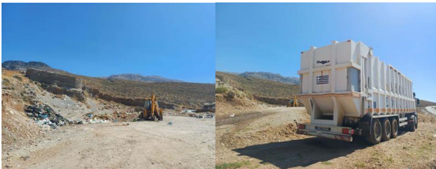
Φωτ. 1 & 2. Σύμμεικτα απόβλητα εναποτεθειμένα στο χώρο και μηχανήμα έργου για την φόρτωσή τους στο κοντέινερ του Δήμου 15/07/2026
